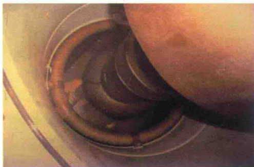
图 2-9 升高座底部交流引出线均压环对油箱盖处放电痕迹
