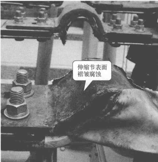
图 1-8 变压器母线桥伸缩节腐蚀
