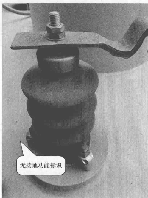
图 1-1 变压器无铁芯、夹件接地标识
