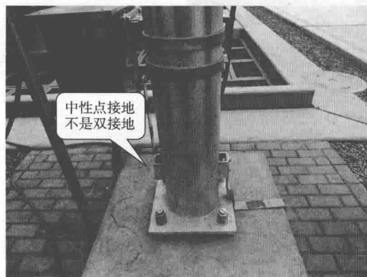
图 1-15 主变压器中性点隔离 开关引下线不是双接地
