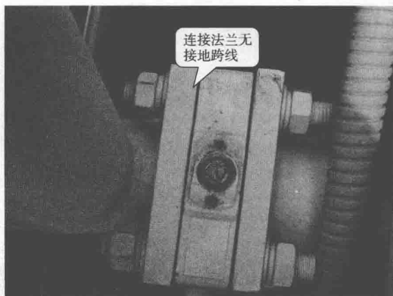
图 1-12 散热器法兰两侧无接地跨连接
