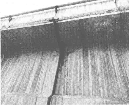
图 2-4 翼缘板腹板交接处斜向裂缝示意图
