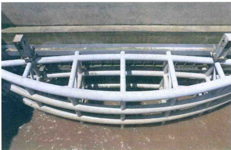
图 1-4 双拱管桁式平面闸门投入运用
