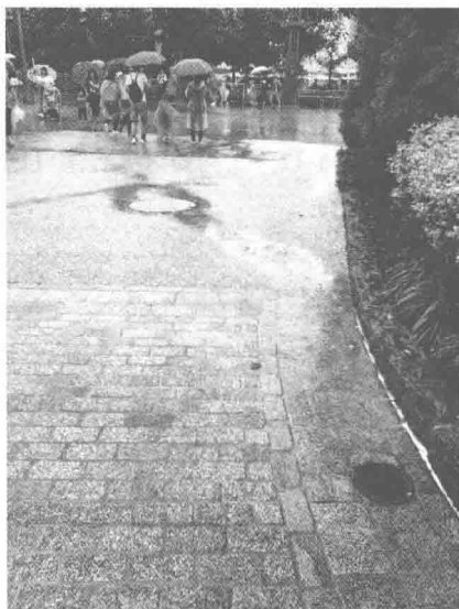
图 1-11 某园区道路积水情况
