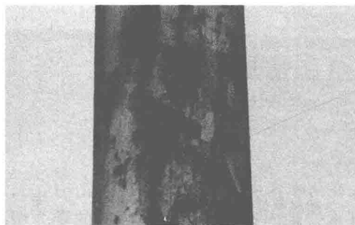
图 1-10 防锈钢管锈蚀开裂渗水
