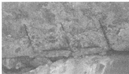
图 1-13 系梁混凝土剥落,露筋锈蚀
