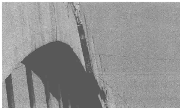
图 1-9 拱肋混凝土开裂
