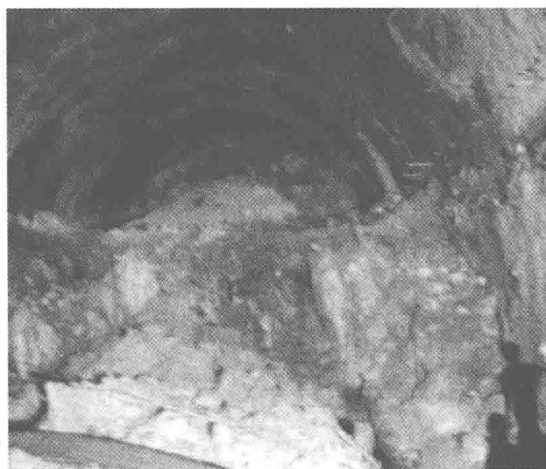
图 1-2 受不良结构面影响引起的隧道掌子面坍塌
