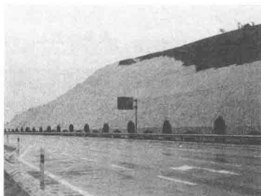
图 1-6 山西太旧高速公路黄土边坡
