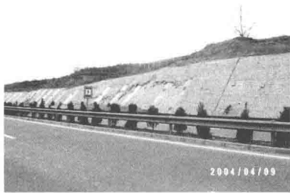
图 1-9 铜黄公路浆砌片石护坡破坏生态
