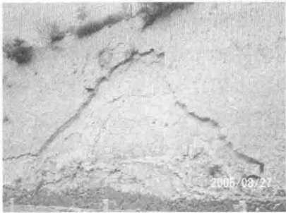
图 1-1 黄延高速公路边坡片状剥落
