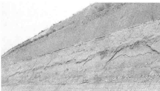
图 2-1 黄土边坡片状剥落(1)
