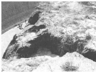
图 1-10 边坡破坏生态后产生的水土流失
