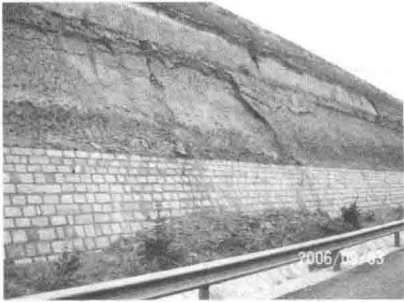
图 1-2 黄延高速公路边坡厚层剥落
