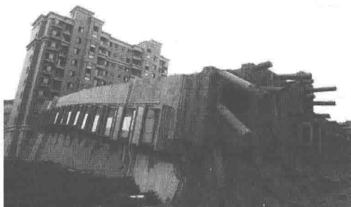
图 1-2 上海某小区房屋整体倒塌
