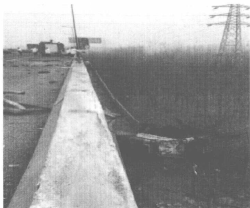
a) 车辆及防落物网坠落桥下
