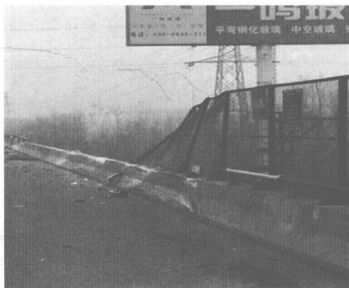
b) 护栏上部钢结构及防落物网损坏
