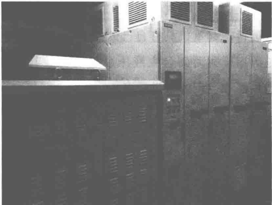
b) 右甲板起重机变频电源实物照片
