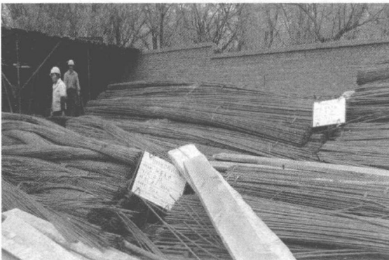
图 1-3 钢筋原材未分类码放
