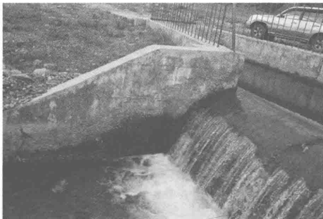
图 1.2 松多电站进水口前池溢流槽冲磨及冻融破坏
