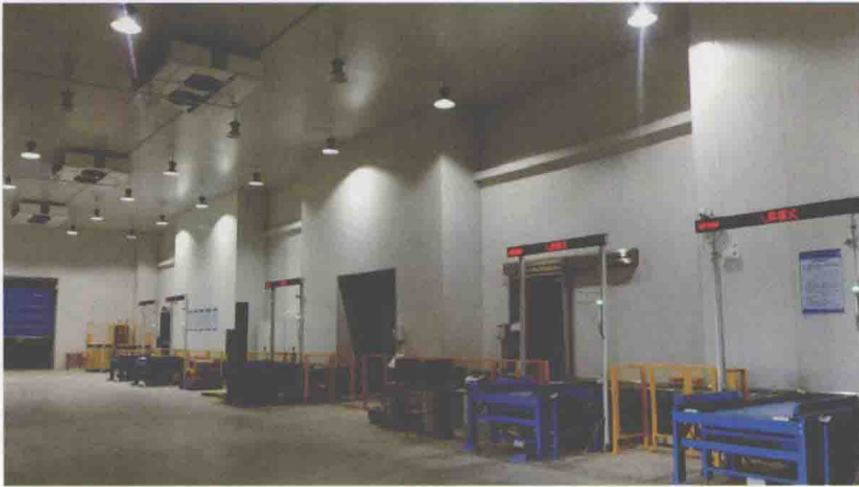
图1 2013年完工的北京京津港冷链物流冷库的低温穿堂
