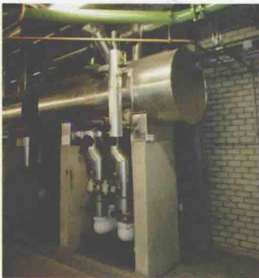
图 11 采用二次节流供液方式, 制冷液体在进入其中一台中温低压循环桶液体节流后, 再向另一台低温低压循环桶进行二次节流供液 (Diepop's-Hertogenbosch B. V., 欧洲)
