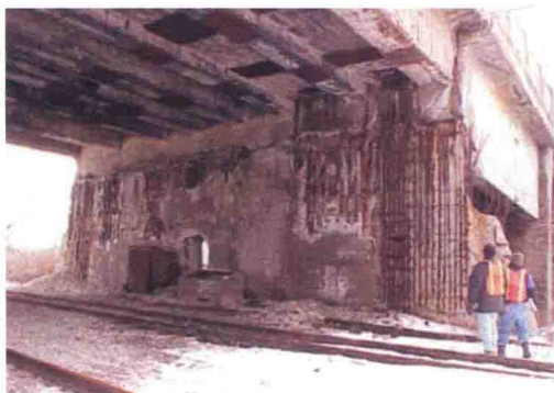
图 3-1 混凝土的冻融循环破坏 ( 52 页 )
