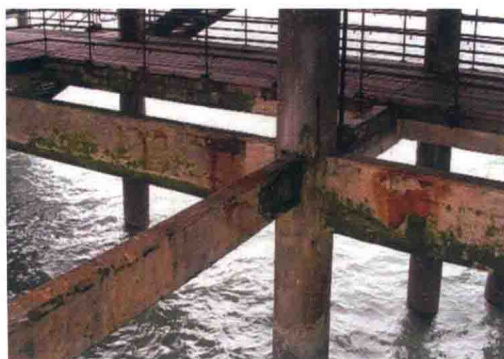
图 3-2 钢筋混凝土的氯盐侵蚀破坏 ( 52 页 )
