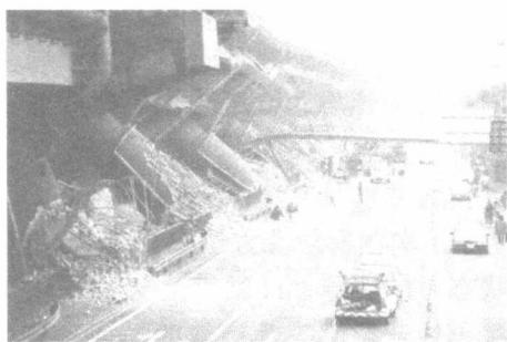
图 1.1 地震中桥墩弯曲破坏实例
