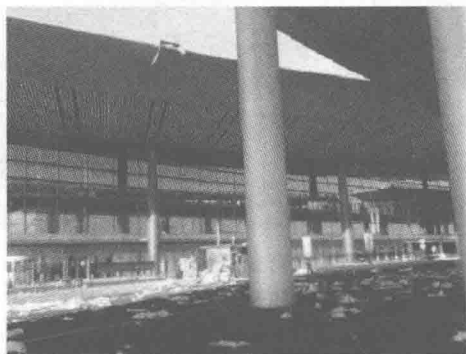
图 1.13 北京首都机场 T3 航站楼被吹落的泡沫
