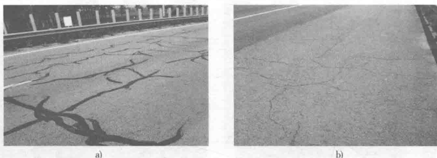
图 1-6 表面层沥青老化导致的块裂
