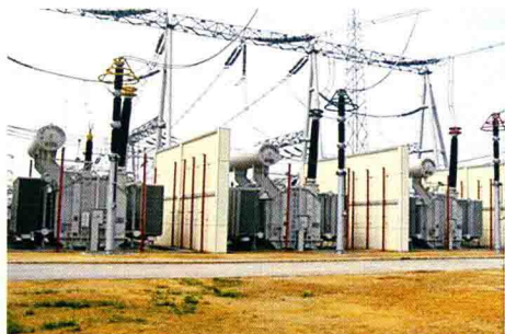
图 2-2 500kV 单相变压器
