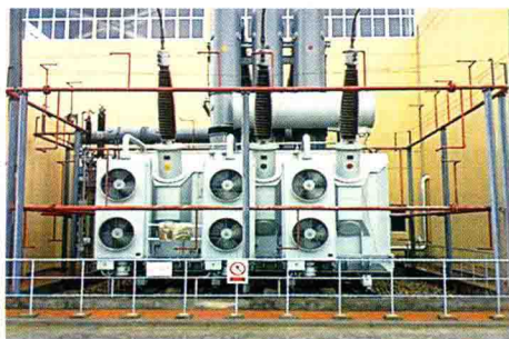
图 2-1 220kV 三相升压变压器
