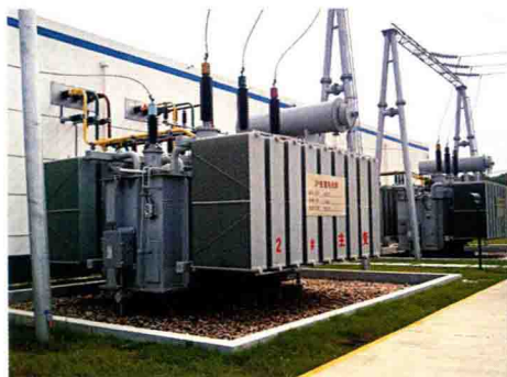
图 2-4 220kV 有载调压变压器
