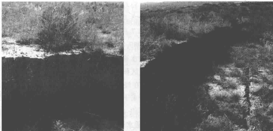
图0-4 刀柱式采空区顶板突然垮落造成的地表变形破坏
