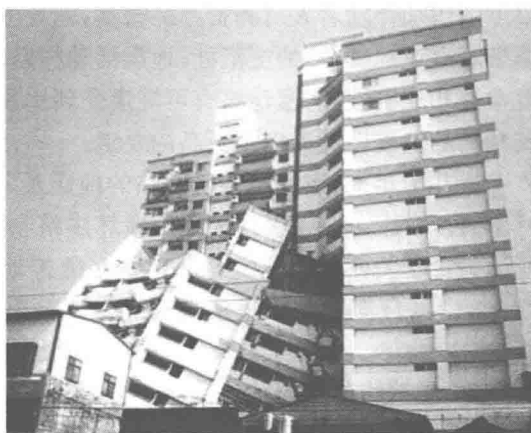
(b) 中国台湾彰化县某高层住宅倒塌
