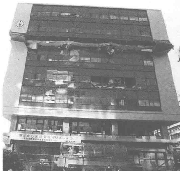
图 1.1 1995 年日本阪神地震中某高层建筑破坏
