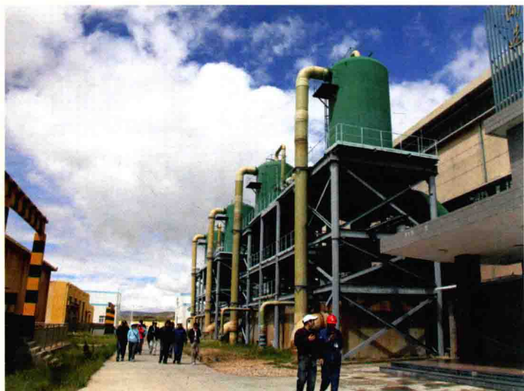
▲ 西藏羊八井地热电站（装机容量 24.18MW）
