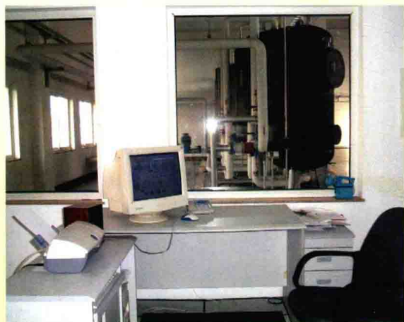
▲ 某建成地热井泵房的电脑操作控制台
