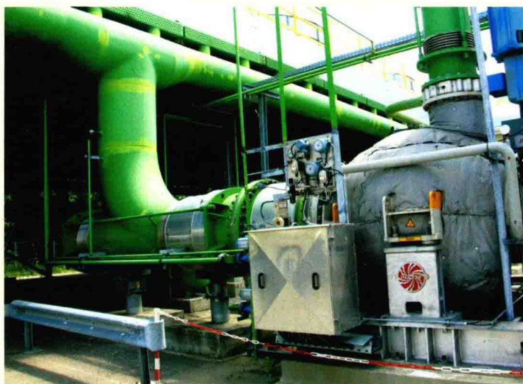
▲ 德国兰道的干热岩 /EGS 发电站 (3MW, 年运行超过 8200h)
