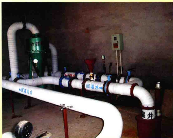
▲ 北京某地热回灌井的井口装置
