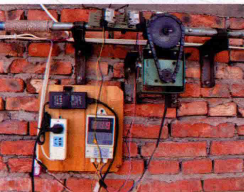
日光温室自动放风系统 (控制顶部放风口)
