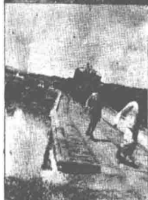
← 太平場便橋損壞情狀
