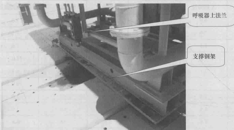
图 1-1 呼吸器下方及电抗器支撑钢架存在大量油迹
