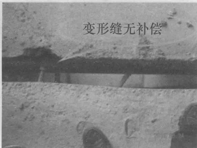
图 1-2 管道穿伸缩缝未加补偿器，管道变形
