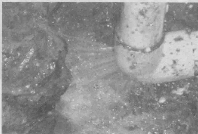
图 1-7 热熔管道接口渗漏
