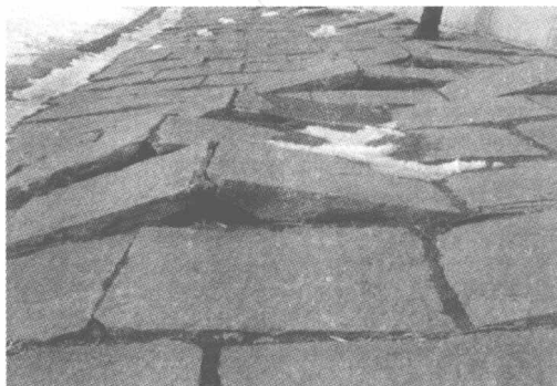
(b) 护坡石板隆起
