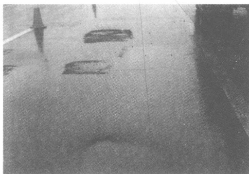
(e) 道路翻浆 (一)
