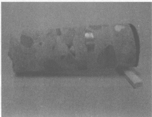
图 1.3-2 防水混凝土振捣不密实 (二)
