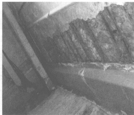
图 1.4-6 结构混凝土内部钢筋锈蚀（二）
