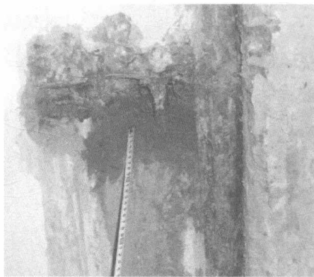
图 1.4-5 结构混凝土内部钢筋锈蚀（一）
