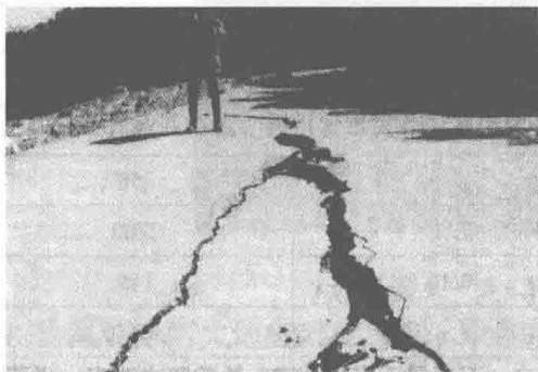
图 1.3.4 丽江地震中柏油路面震裂
