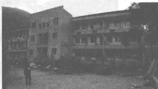
图 1.3.10 地基失效北川中学五层教学楼仅剩三层
