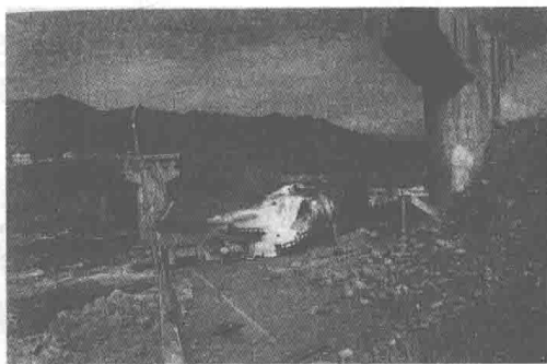
图 1.3.13 地下柱破坏导致路面下陷
