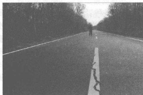
(c) 吉林环长白山线路路基路面纵向裂缝
