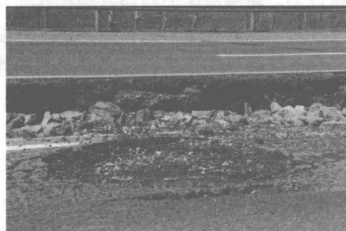
(a) 长春-松原K65+100道路冻胀翻浆
