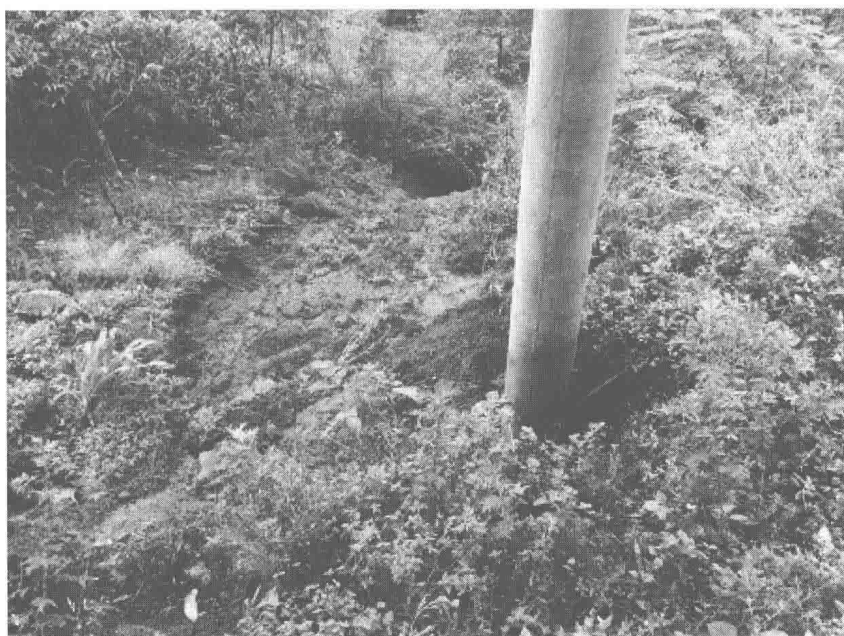
图 1-1-3 电杆基础被冲刷
