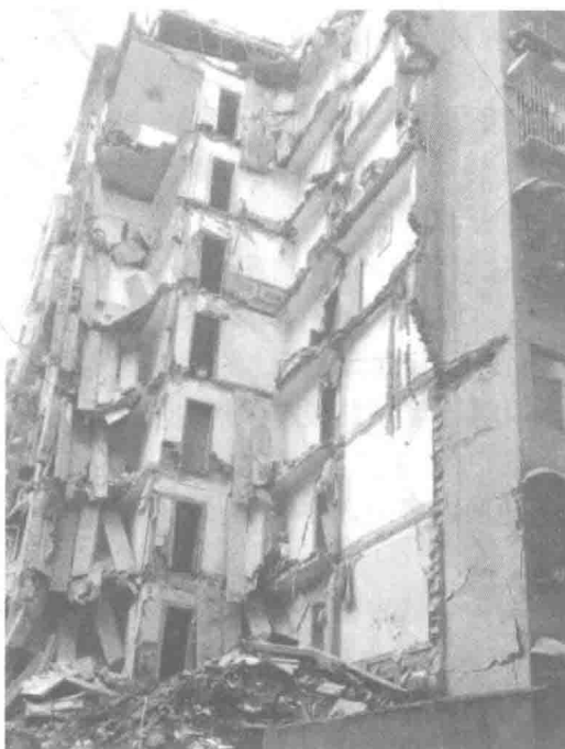
图 1.3-5 贵州某居民楼局部倒塌
