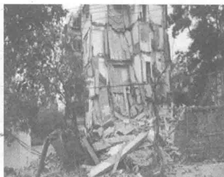
图 1.3-2 浙江某教师集资房坍塌
