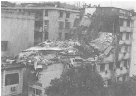
图 1.3-9 江西某住宅楼局部倒塌
