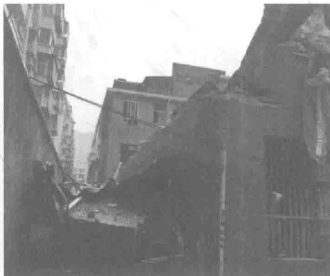
图 1.3-10 上海某住宅倒塌
