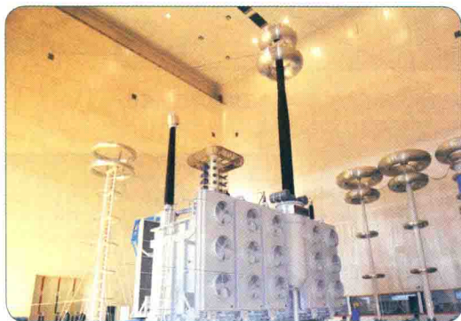
1500MVA可解体特高压变压器研制成功。
