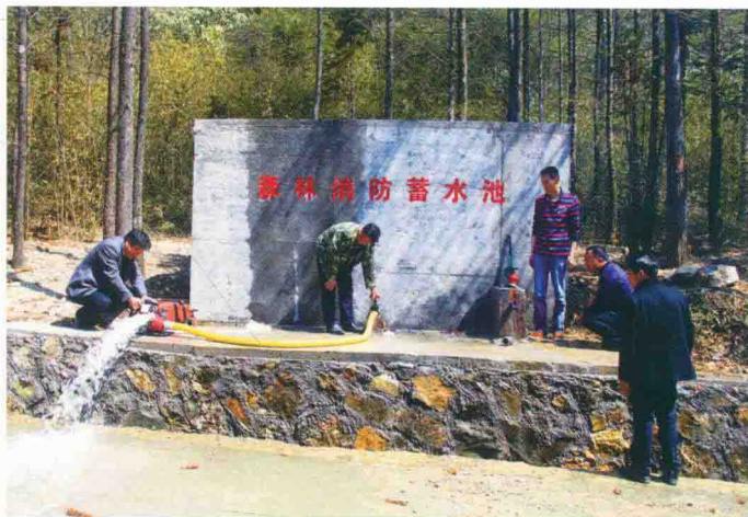
2013年3月6日，灭火水泵维护
