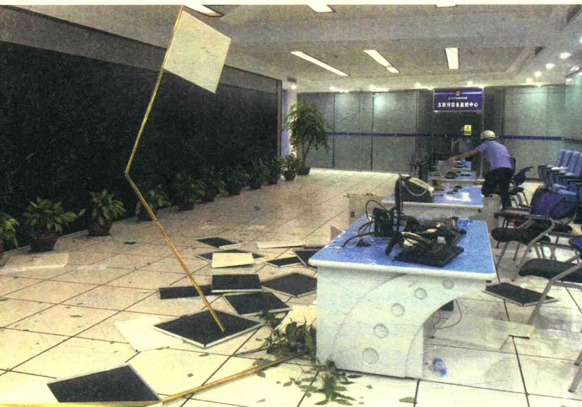
被“莫兰蒂”台风严重损坏的集美分局指挥情报中心（警方供图）
