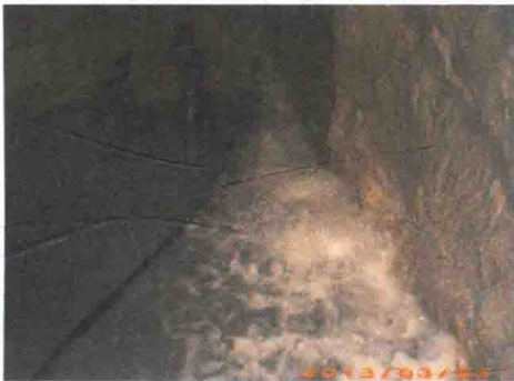
图 1-2 3# 支洞引 7+925 处涌水
