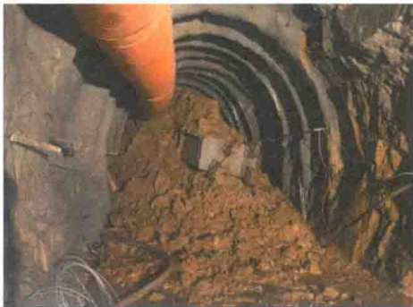
图 1-3 洞内突泥（损毁机具）
