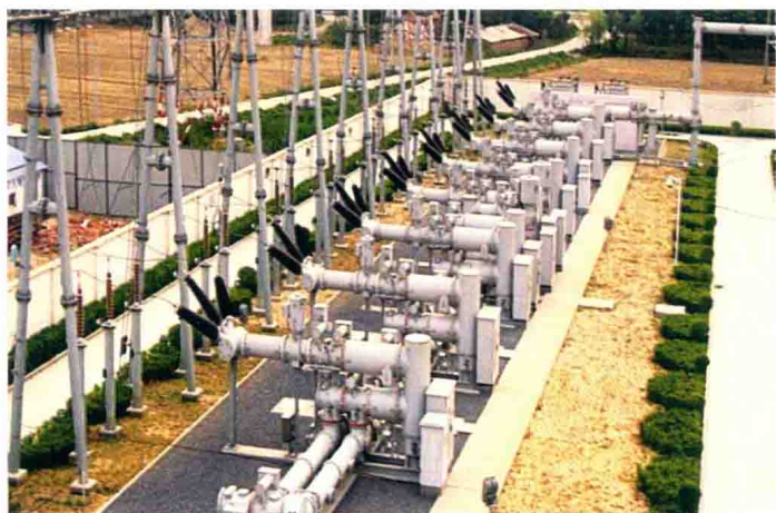
图 2-2 气体绝缘金属封闭开关设备
