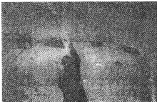
图 0-1 清华大学第三教室楼配电站墙体开裂
