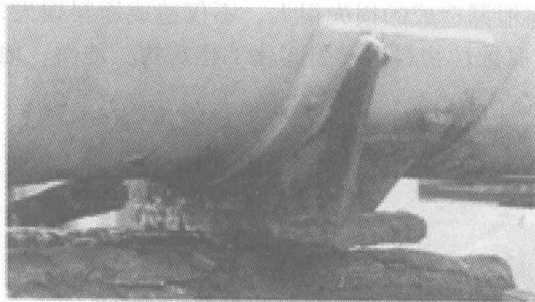
图 0-4 设备支座出现的严重腐蚀
