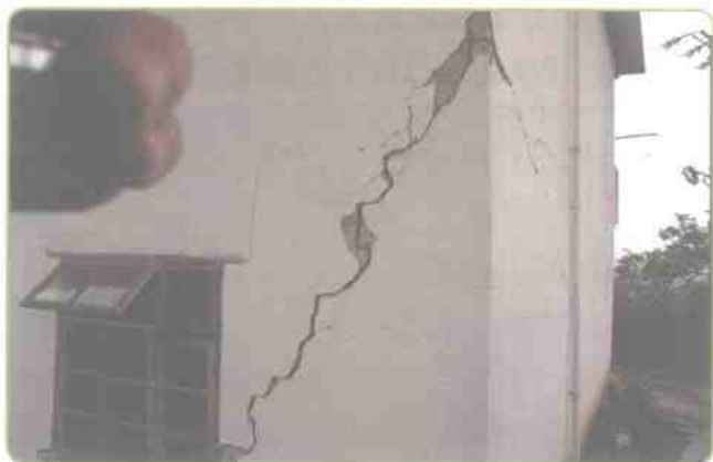
房屋开裂变形
