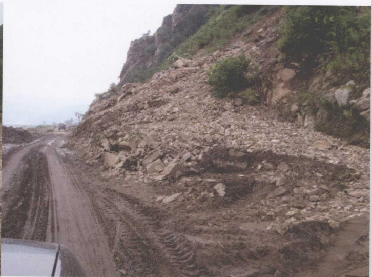
新宾满族自治县被山体滑坡掩埋的公路。
