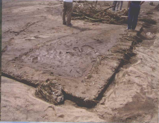
抚顺县马圈子乡金斗村大水后一农家仅存的房基。
