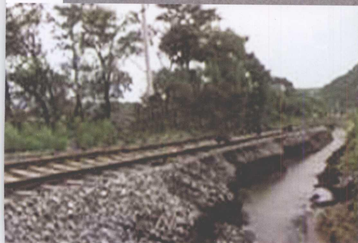
被冲毁路基的沈吉铁路清原段。
