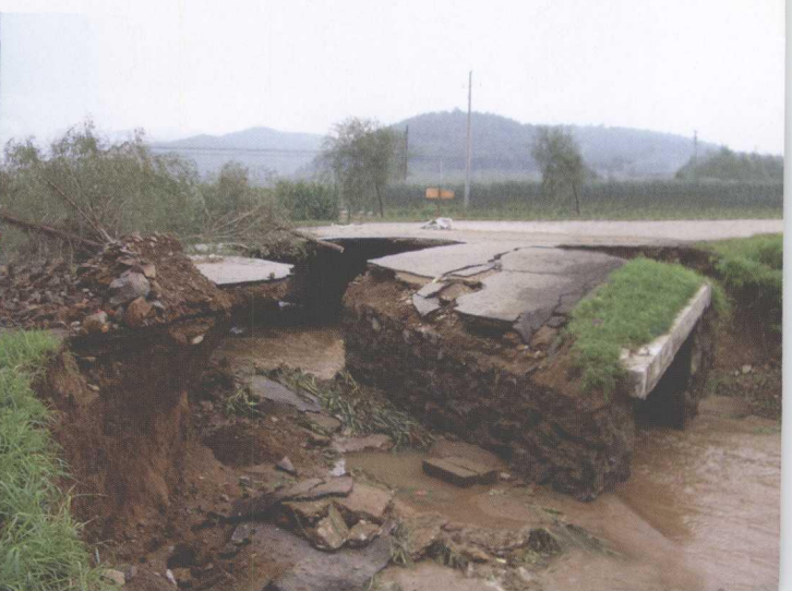
抚顺县石文镇水毁公路。
