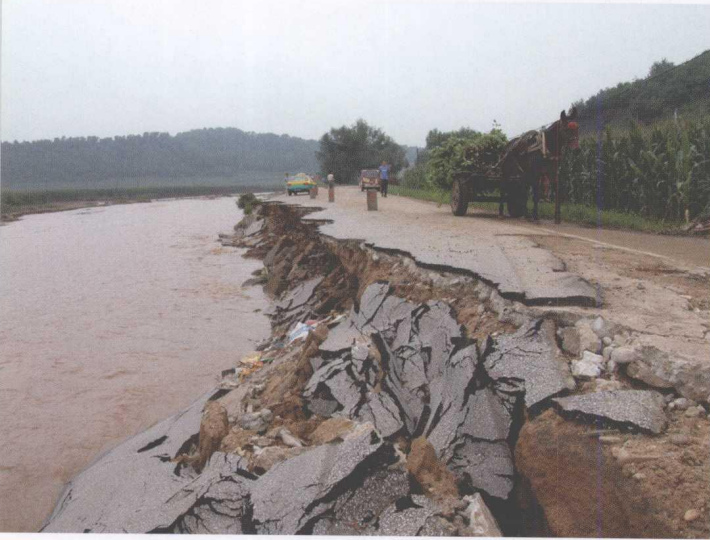
沈通线东洲区碾盘乡萝卜坎段被水毁公路。
