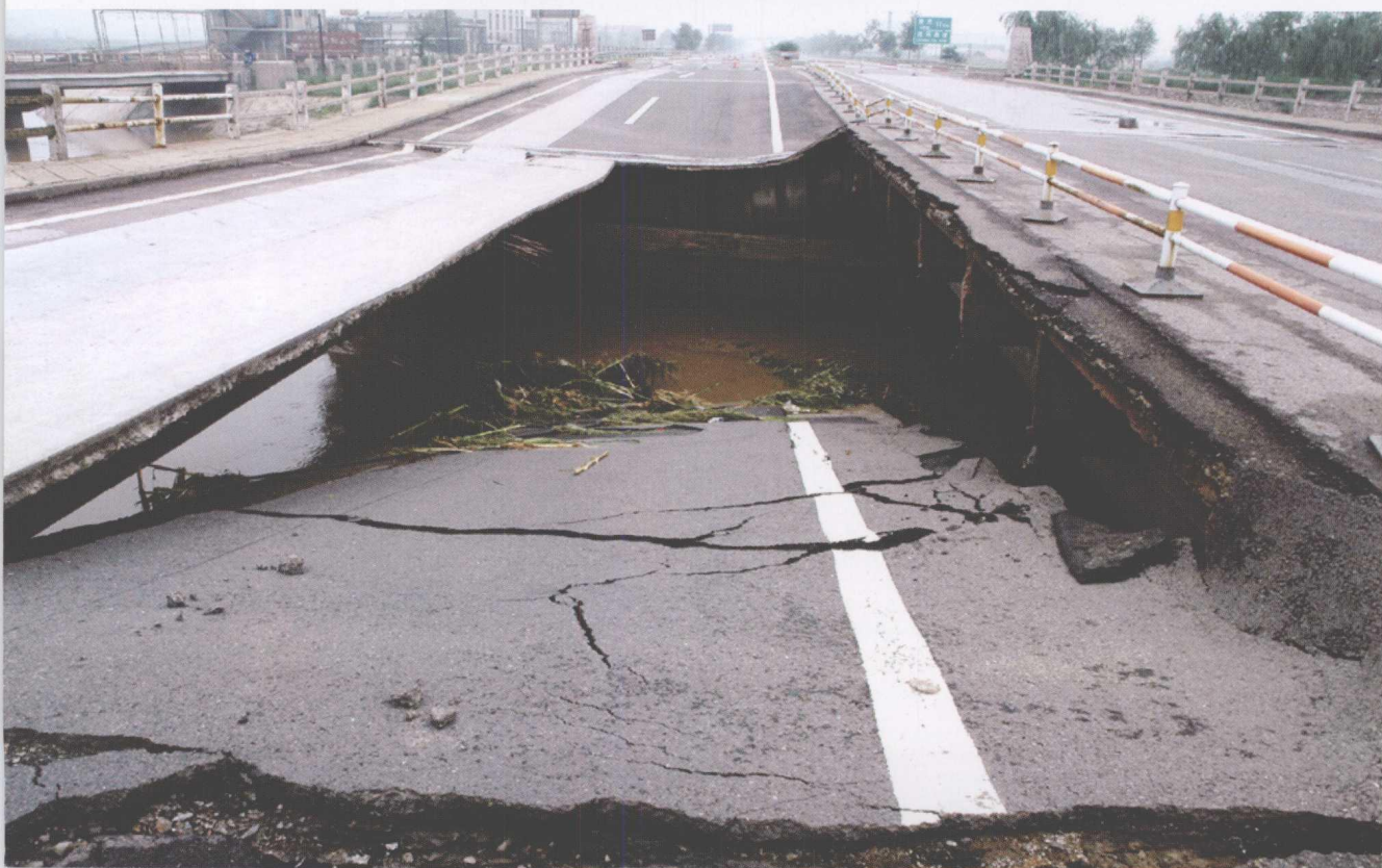
沈抚高速公路李石寨桥南侧桥墩下陷,造成路面坍塌,八月十四日被迫封闭。
