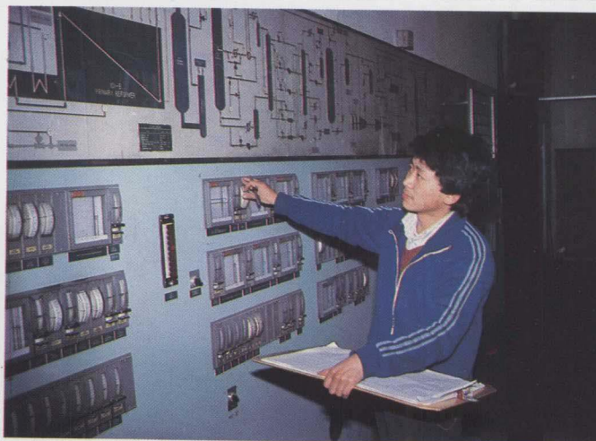
合成车间主控制室
