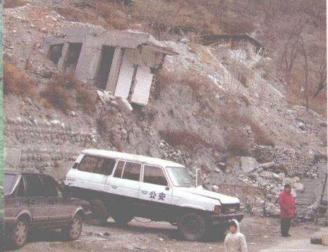
被滑坡破坏的房屋
