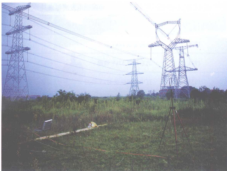
图 1-9 2007 年 2 月, 1000kV 交流试验线段在武汉建成
