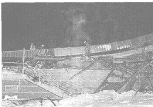
图 1-1 莫斯科德兰士瓦水上乐园屋顶坍塌
