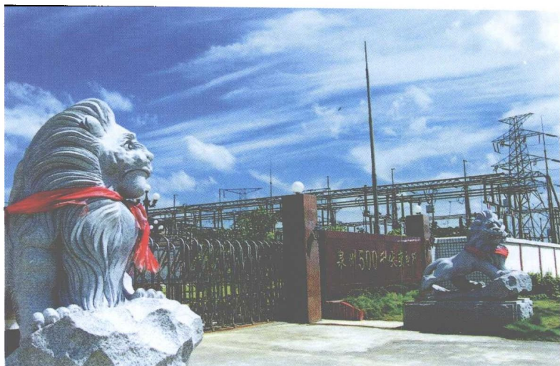
由省调直接调度的福建省第一座 500 千伏变电站——泉州变电站
