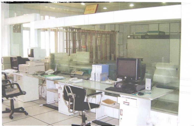
省调程控交换机房
