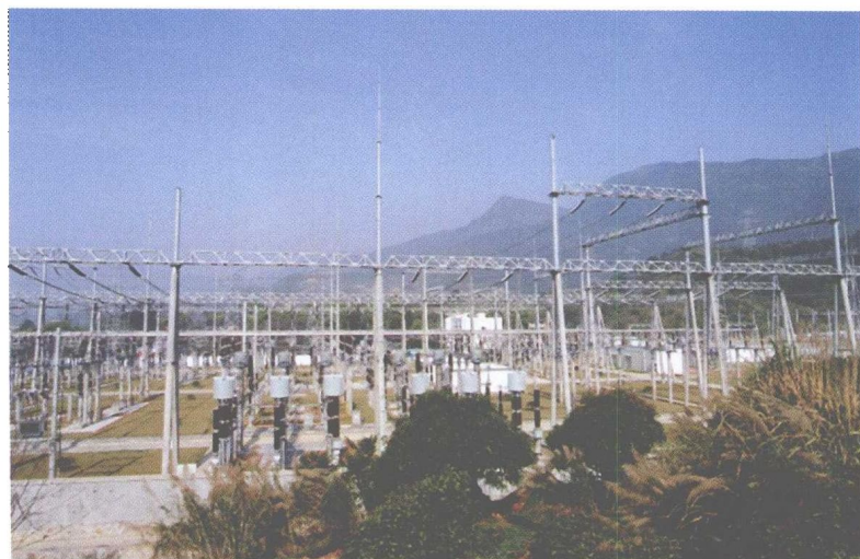
由省调直接调度的福州 500 千伏变电站，福建电网由此出线与华东联网运行
