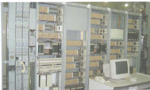
省调数字微波通信 机房
