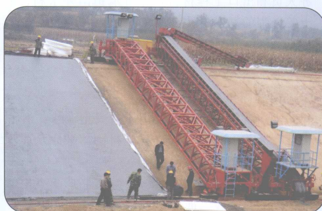
■ CM系列振动碾压衬砌机（南水北调中线工程衬砌）
