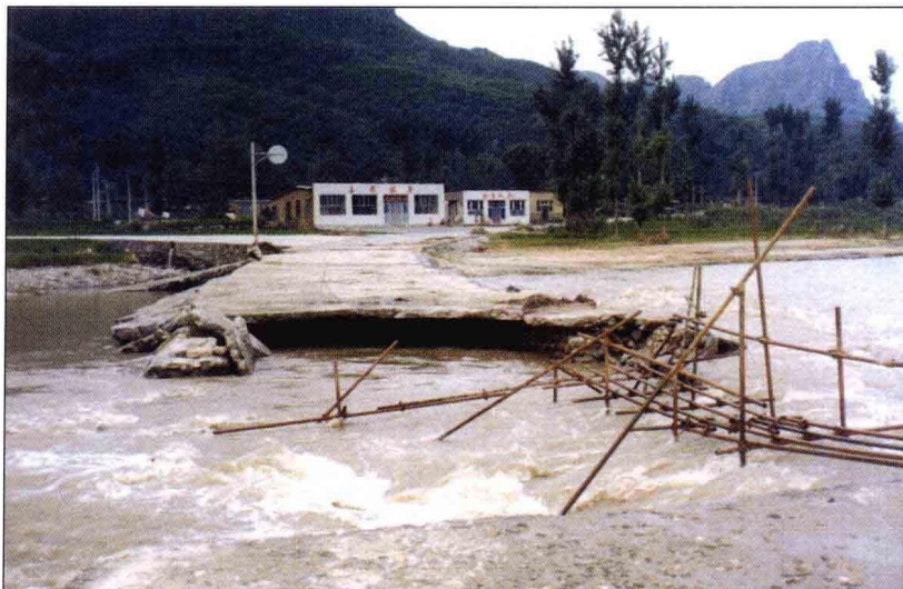
1996年拒马河洪水冲毁的桥梁
