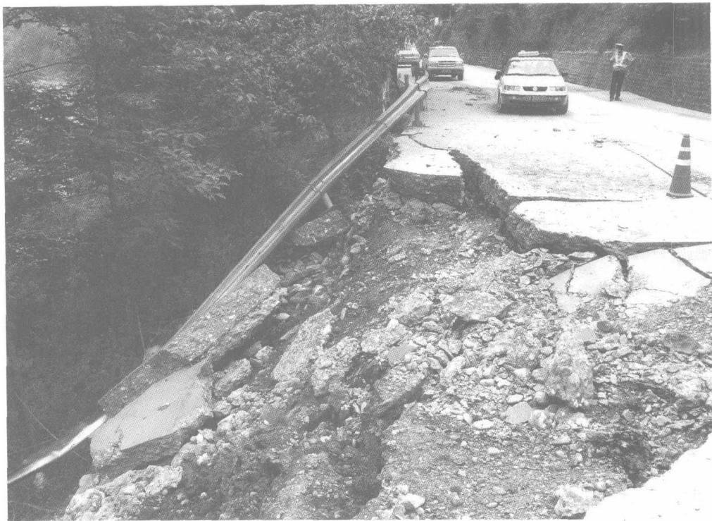
▲ 千里之遥，多处公路塌陷
