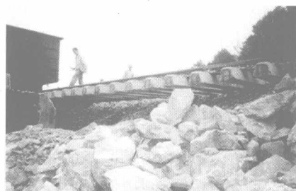
图 2-10 铁路路基滑坡
